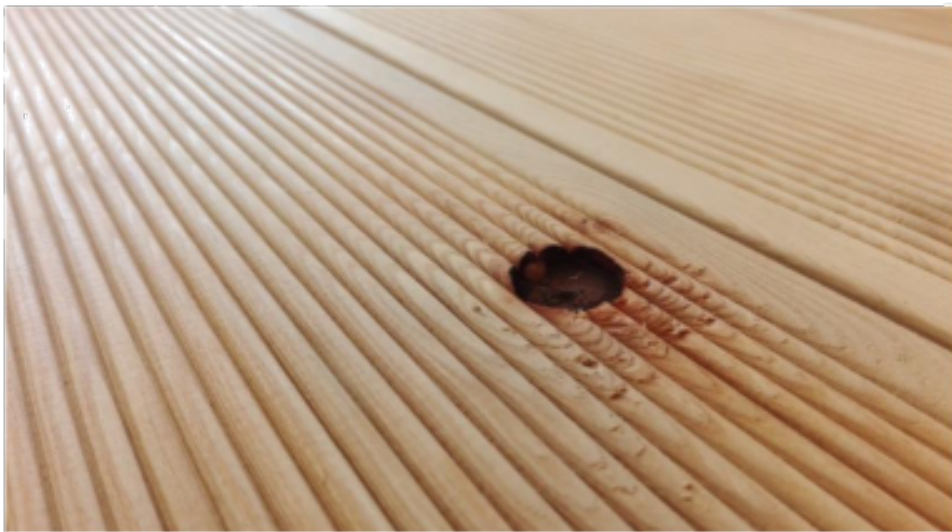
Fot. 11 - sęk wypadnięty na powierzchni deski
